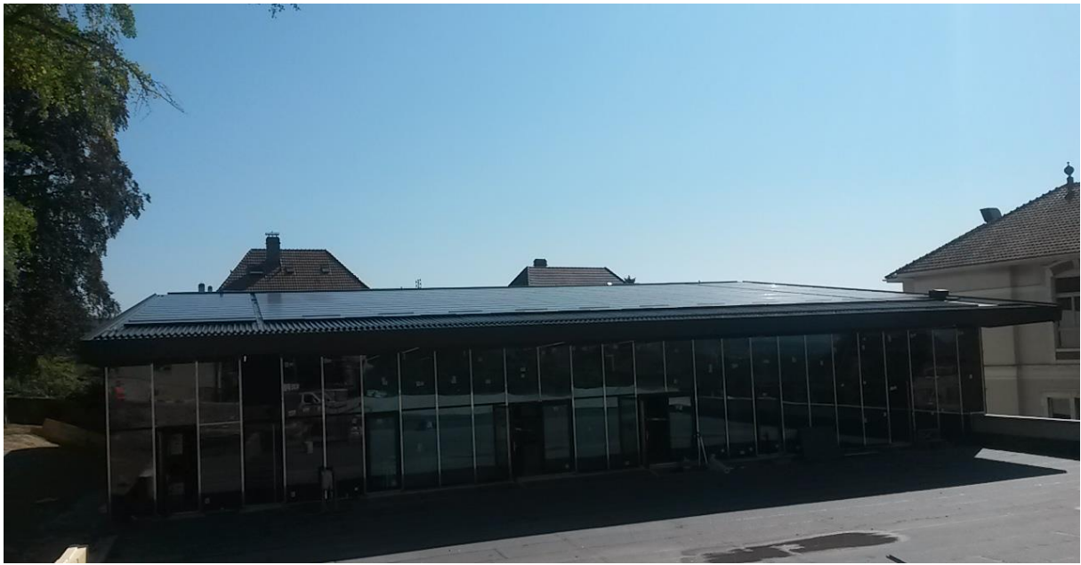
Centrale solaire de 120 kilowatt sur le toit de la nouvelle halle de gym « Juliette » à Corcelles-Cormondrèche, vue du pan ouest
