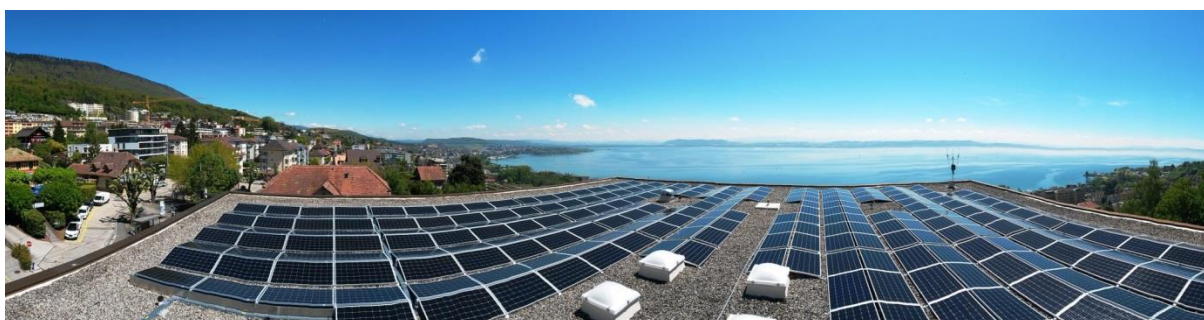
Installation de 100 kWc de Coopsol à la Coudre, Neuchâtel
