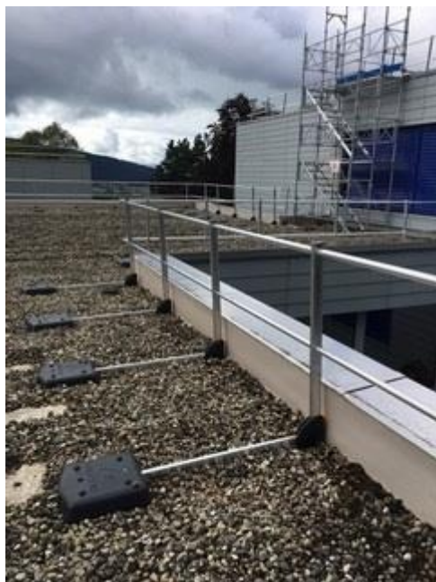
Photo 1 : gardes de corps permanents
