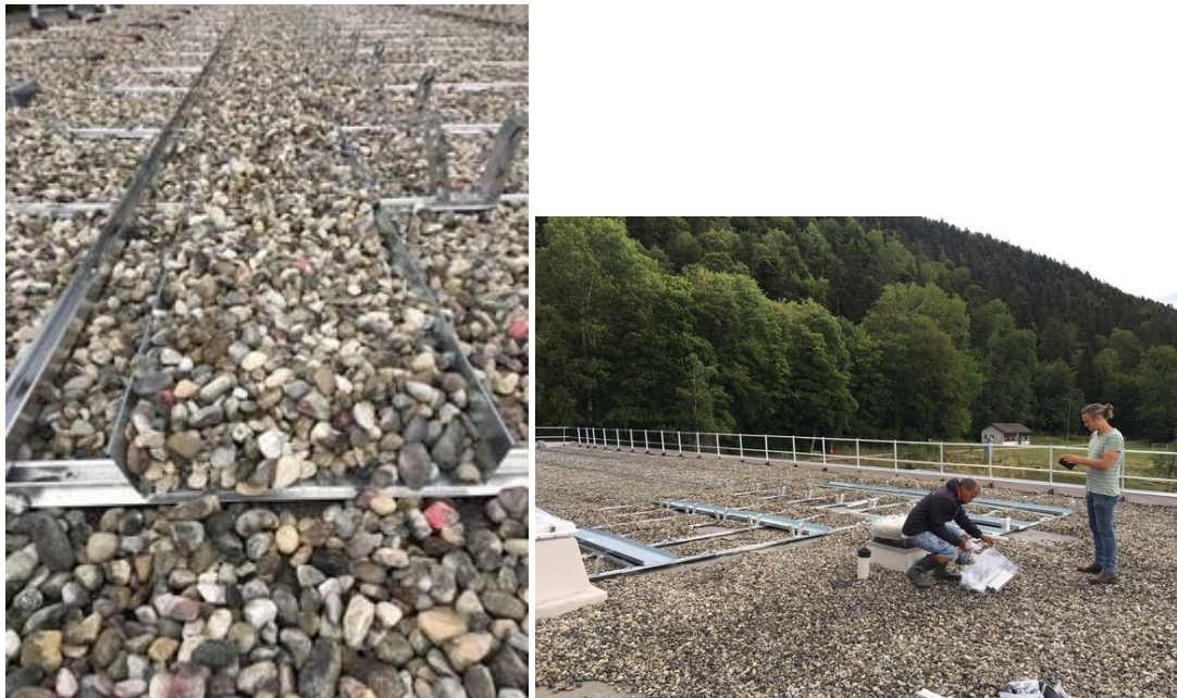
Photos 4 : Bac rempli de gravier / Photo 5 : Travaux en cours sur bâtiment E1
